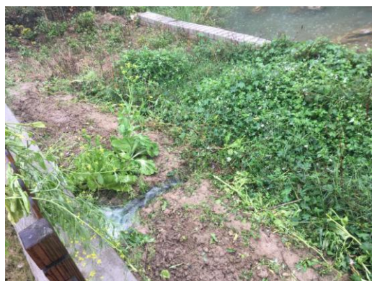
未设置排水口排水管道导致部分废水渗入土地
