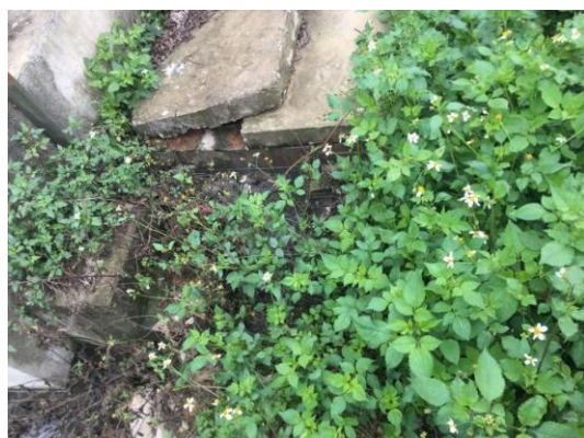
进水口水满溢流至周边
