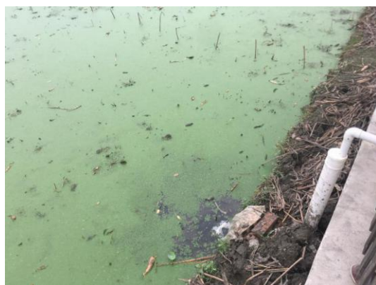
排水口管道破损导致废水排入水田
