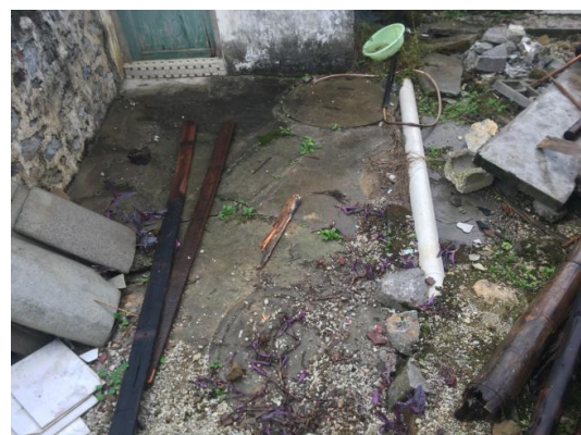
化粪池管道明管敷设易产生破损
