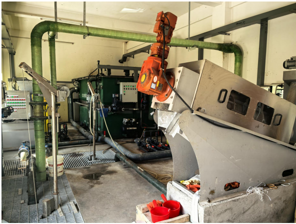
项目污水处理站
