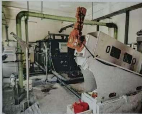
项目污水处理站
