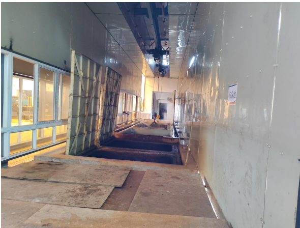
项目线材酸洗磷化皂化区
