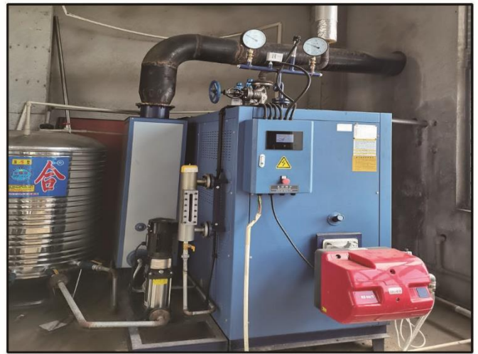
现有0.5t/h蒸汽发生器
