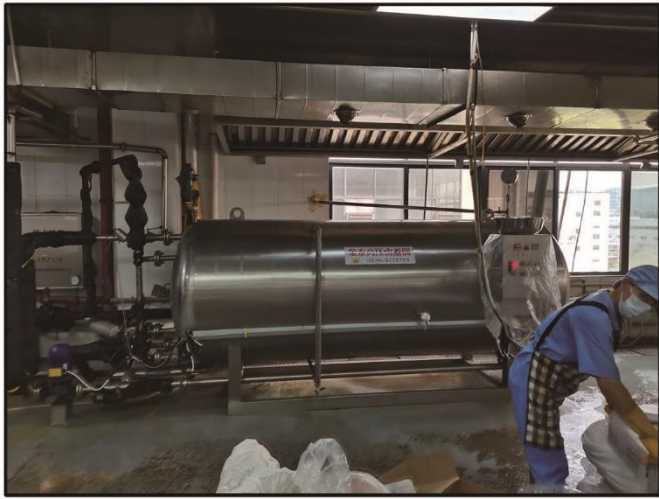
新增的高压卤煮锅
