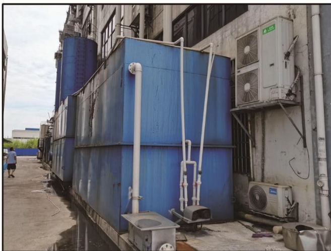
现有一体化污水处理设备
