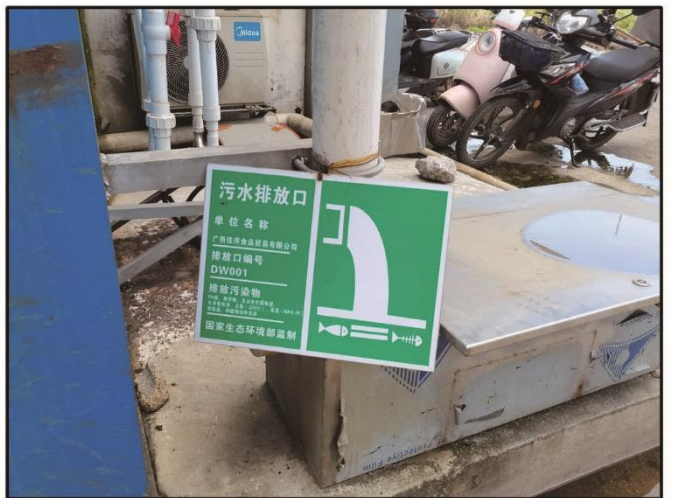
现有生产废水排放口
