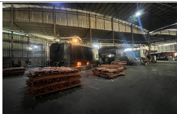
项目锅炉现状
