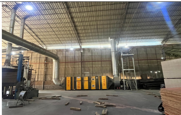
项目热压废气处理措施
