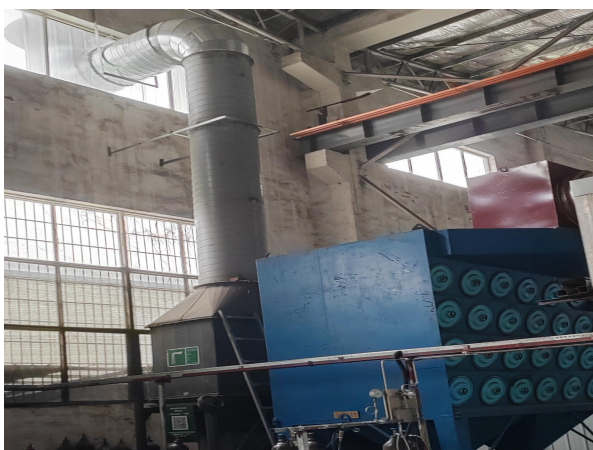
废气处理设施
